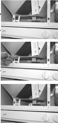
Bypassklappe in Sommerstellung. Die Bypassklappe kann durch Verschieben derselben hinter die Halterung in Winterstellung gebracht werden.
