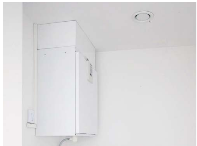
Die Komfortlüftungsgeräte vom Typ „VALLOX Professional Line“ konnten durch ihre kompakten Abmessungen platzsparend in den Hauswirtschaftsräumen der Wohnungen installiert werden.
