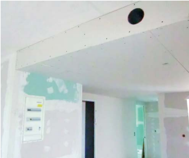
Die Luftverteilung für Zuluft und Abluft innerhalb der Wohnungen verläuft in einer Deckenabhängung im Flur. Bild: Bauverein Sarstedt eG
