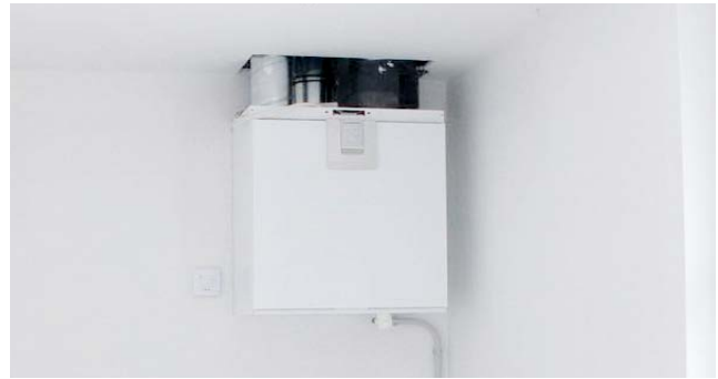
Kontrollierte Wohnungslüftung ist auch im Geschosswohnungsbau längst kein Nischenprodukt mehr. In einem Neubau-Mehrfamilienhaus wurden alle 15 Mietwohnungen mit einem eigenen Kompaktlüftungsgerät mit Wärmerückgewinnung ausgerüstet.
