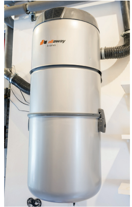
Quelle: Michael Wohlfromm - A30 Herzstück der Zentralstaubsaug-Anlage
