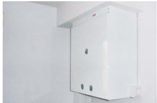
Vallox Lüftungsgerät mit Wärmerückgewinnung im Abstellraum
