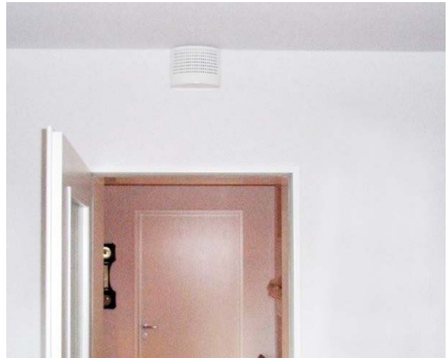
ValloFlex Zuluftventil im Wohnzimmer
